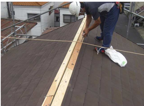
新たに貫板を設置していきます。 コーキングした後、ビスを止めていきます。
