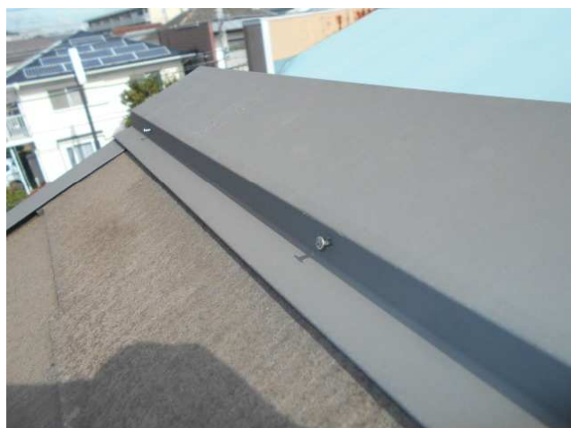
6. 数ヶ所に釘が抜けていました。修理していきます。
